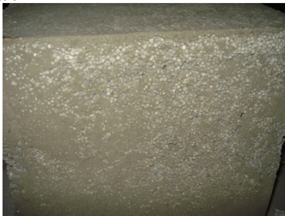
Fig. 09- Estrutura porosa da caixa de Concreto leve com densidade nominal de 700 Kg/m 3 .
